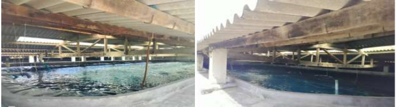
Hình 1. Khu xử lý nước biển của Cơ sở
